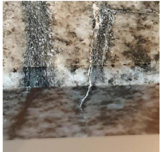
Närbild på en kant och skivans undersida med genomgående brott och synligt mellanrum mellan brottytorna.
