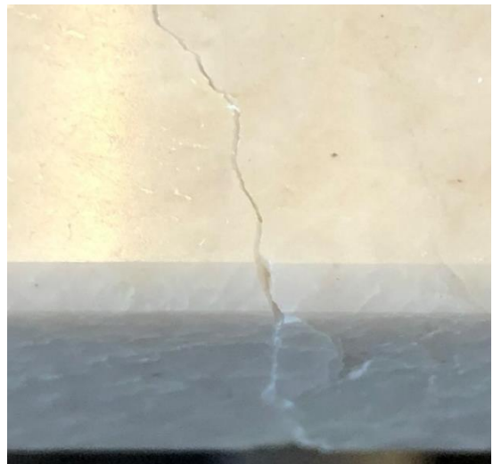
Exempel på ett genomgående brott med tydligt mellanrum mellan brottytorna.
