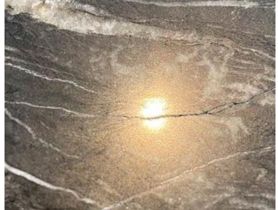
Her ses en sprekk som løper langs et naturlig åreforløp.
