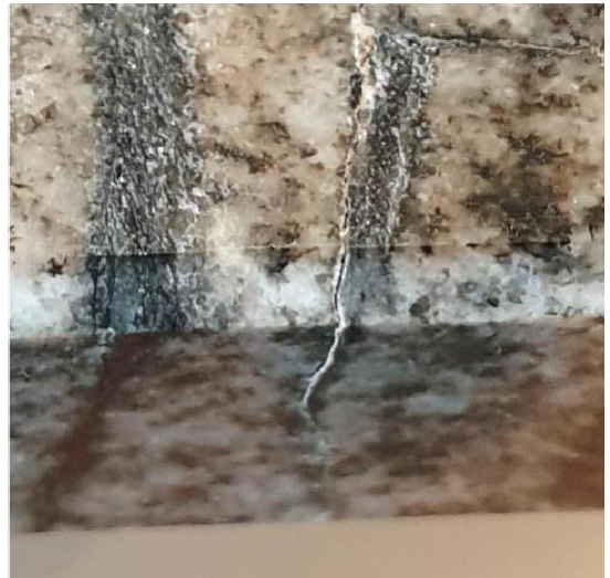
Close-up av en forkant og undersiden av platen med gjennomgående sprekk og synlig mellomrom mellom bruddflatene.
