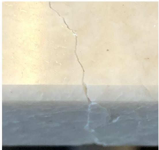
Et eksempel på en gjennomgående sprekk med et tydelig mellomrom mellom bruddflatene.
