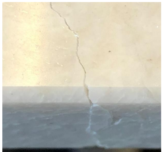
Et eksempel på en gennemgående revne med et tydeligt mellemrum mellem brudfladerne.
