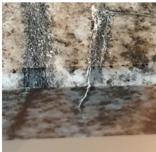
Här är en närbild av en framkant. Lägg märke till att det finns mellanrum i sprickan och att den fortsätter genom hela skivans tjocklek.
