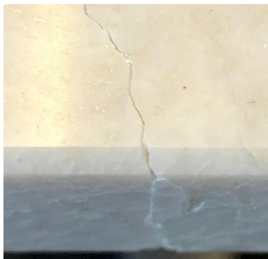
Ytterligare ett exempel på en genomgående spricka med mellanrum. Detta är ett mycket tydligt exempel
