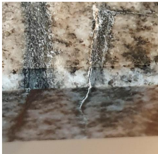
Her sees et nærbilde av en forkant. Legg merke til at det er mellomrom i revnen, og at den er gjennomgående i platens tykkelse.
