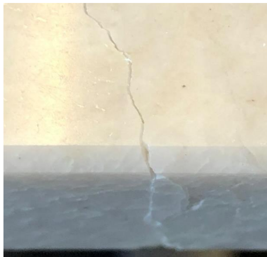
Enda et eksempel på en gjennomgående revne med mellomrom. Dette er et svært tydelig eksempel
