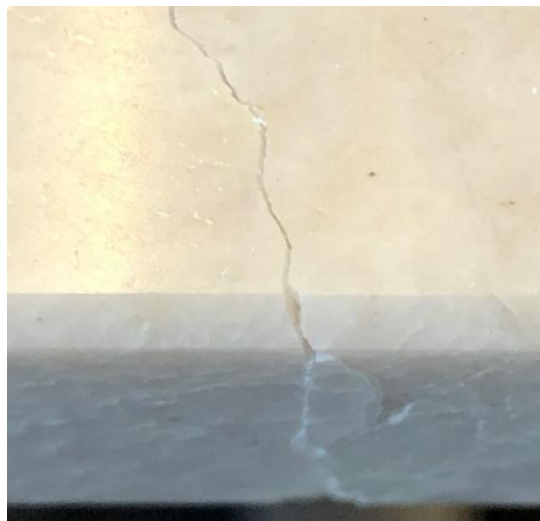
Endnu et eksempel på en gennemgående revne med mellemrum. Dette er et meget tydeligt eksempel
